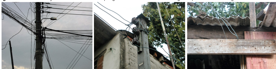
Figura 1 – Documentação dos alunos sobre os perigos das conexões elétricas ilegais e postes sobrecarregados
